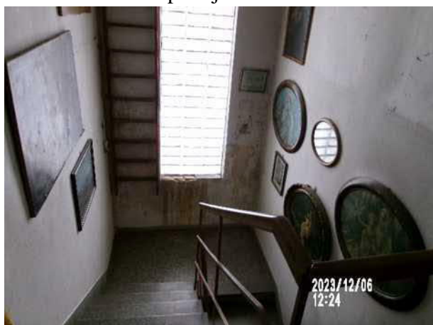
schodiště, luxfery, plíseň na zdivu
